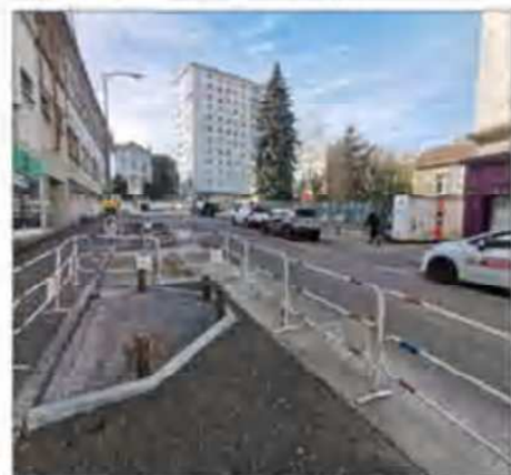
On commence à en voir le bout avenue de Lattre-de-Tassigny où des travaux sont prévus les trois prochaines nuits. Photo VM/Jean-Christophe PIGNON
